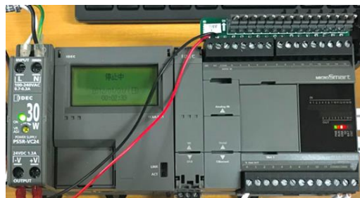
Fig. 2 実験用照明システムに使用した PLC
