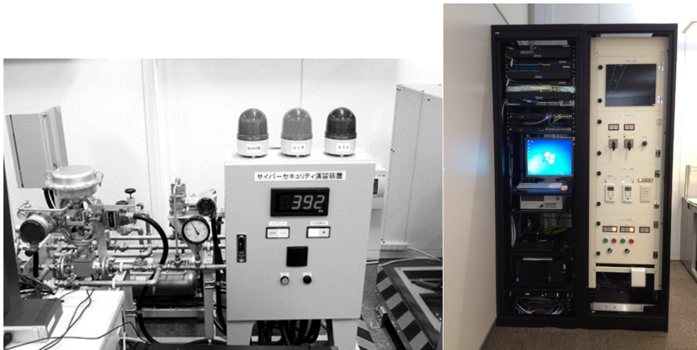
図4 ガス模擬プラント（左）とビル模擬プラント（右）
